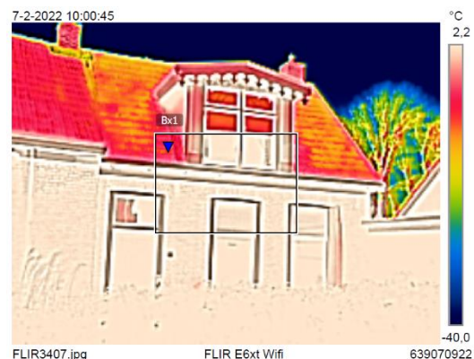
Foto 2: Het linkerdeel van het dak is dankzij de luchtdichte constructie beter geïsoleerd dan het rechterdeel terwijl rechts de laag isolatiemateriaal dikker is dan links.
